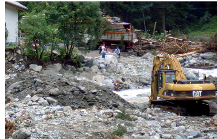
Abb. 15: Nach dem Hochwasser gilt es, Gewässer und Schutzbauten so rasch als möglich provisorisch wieder herzustellen. Vorausschauend zusammen mit den Einsatzorganisationen erstellte Hochwassereinsatzpläne leisten dabei wertvolle Dienste.
